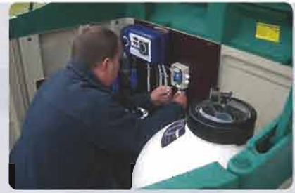
Installatie in een thuiskast
